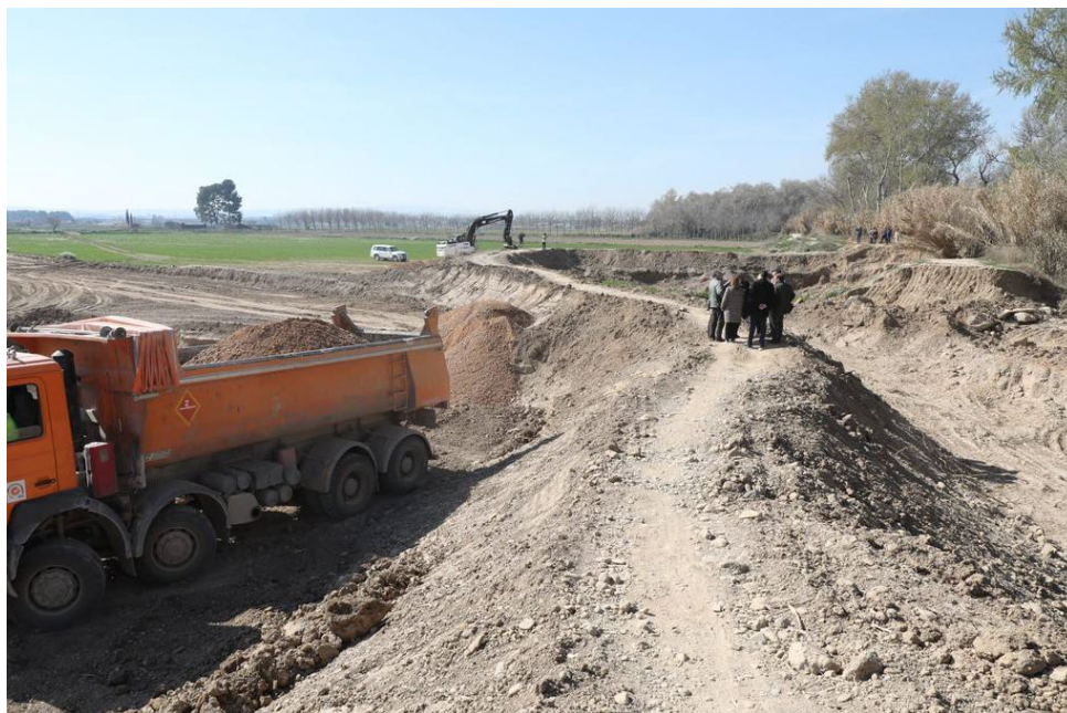
Consolidation work on the protective mote in the river Ebro. Source: El Periódico de Aragón.
