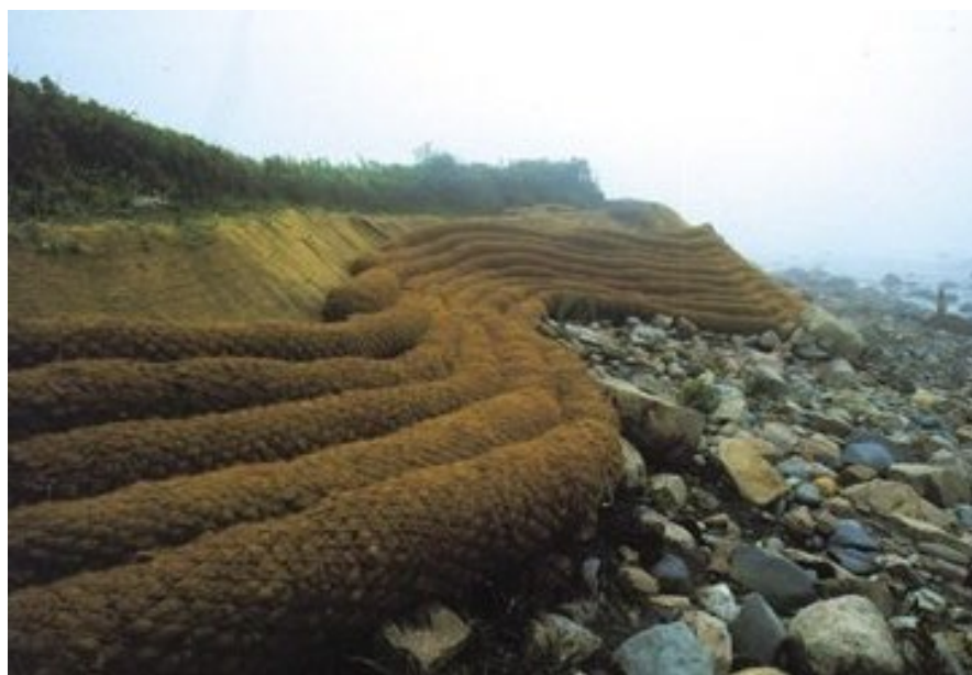
Processo de estabilização de um talude em Massachusetts. Fuente: New England Environmental.
